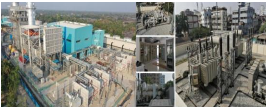
图 7：孟加拉 300MW 联合循环电站
