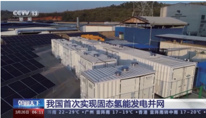
参与我国首个固态氢能发电并网项目，项目通过利用可再生能源制氢实现“绿电”与“绿氢”灵活转换
