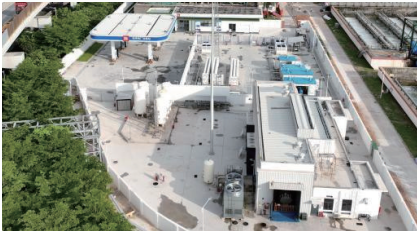
深圳妈湾电厂制氢加氢一体项目，助力构建完善的氢能供应体系
