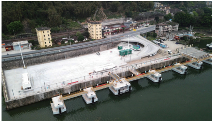
厚普船用自研的船舶加注站设备应用于中海油首座岸基式 LNG 船舶加注站，保障清洁能源在船舶领域应用的基础设施建设
