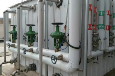
热水控温换热装置
