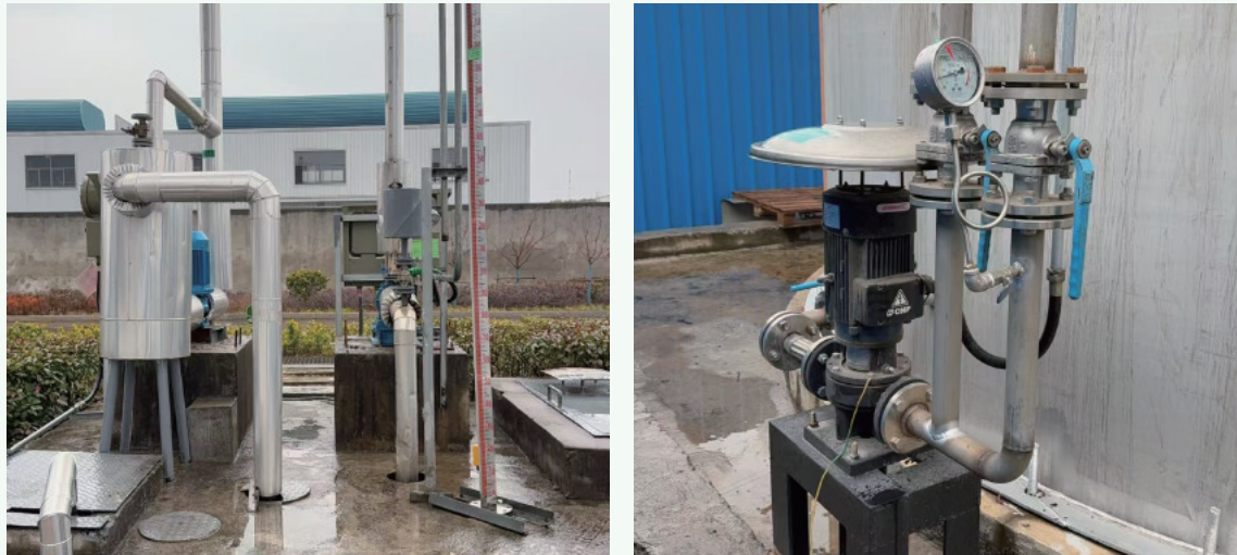
马鞍山科思设置罐区集水池和回水泵
