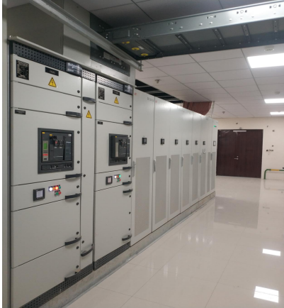
10kV直转380V直流电源系统
