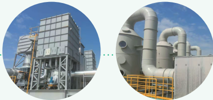
废气处理设施
