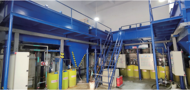
⇨ 污水站(升级改造后)
