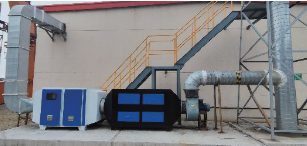
⇨ 危废库废气净化设施
