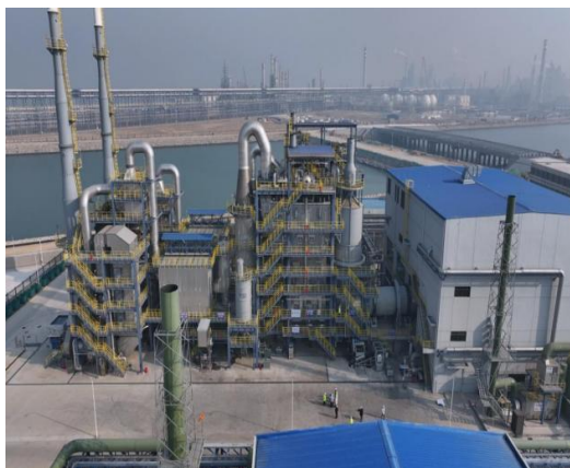
浙石化废气废液焚烧系统
