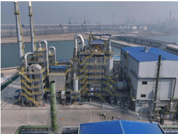
浙石化废气废液焚烧系统
