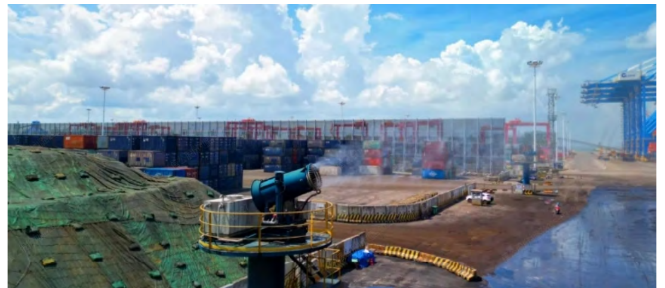
北海码头雾炮供水系统
