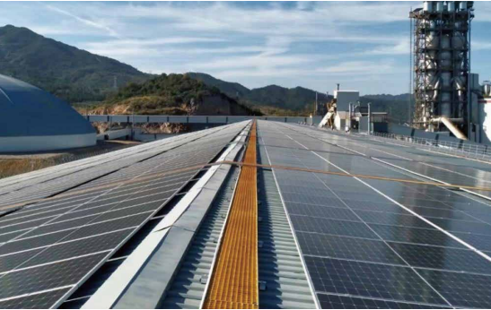
◎贵州都匀分布式光伏发电项目
