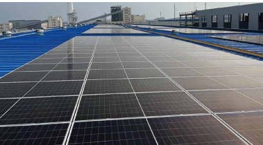
◎安庆科摩尔800kWp光伏发电项目
