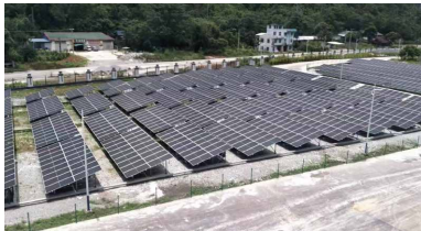
◎都安上峰2510kWp光伏发电项目
