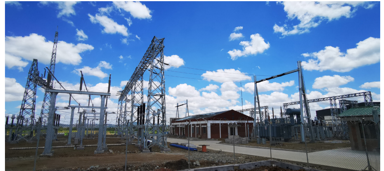
Bikita 参与投资修建的 132 KV 高压输电线路
