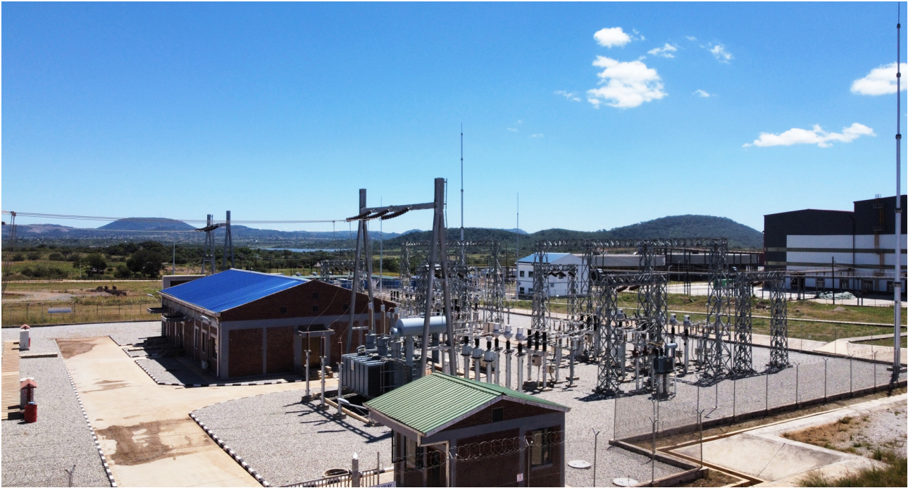
Bikita 132 kV 变电站工程
