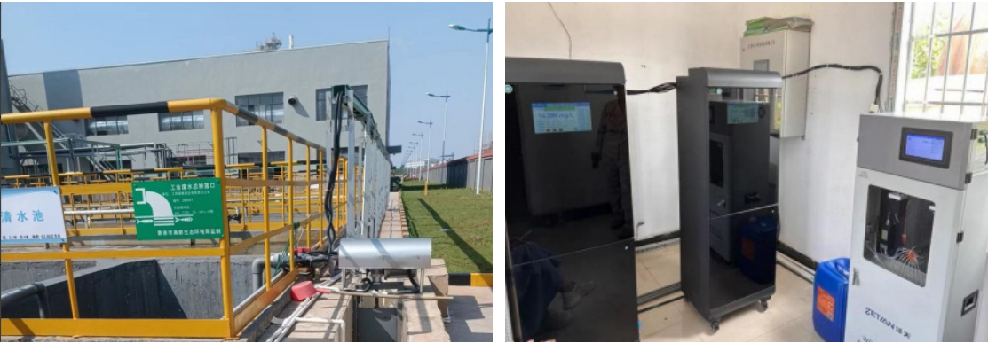
江西中矿锂业废水总排口和在线监测设备
