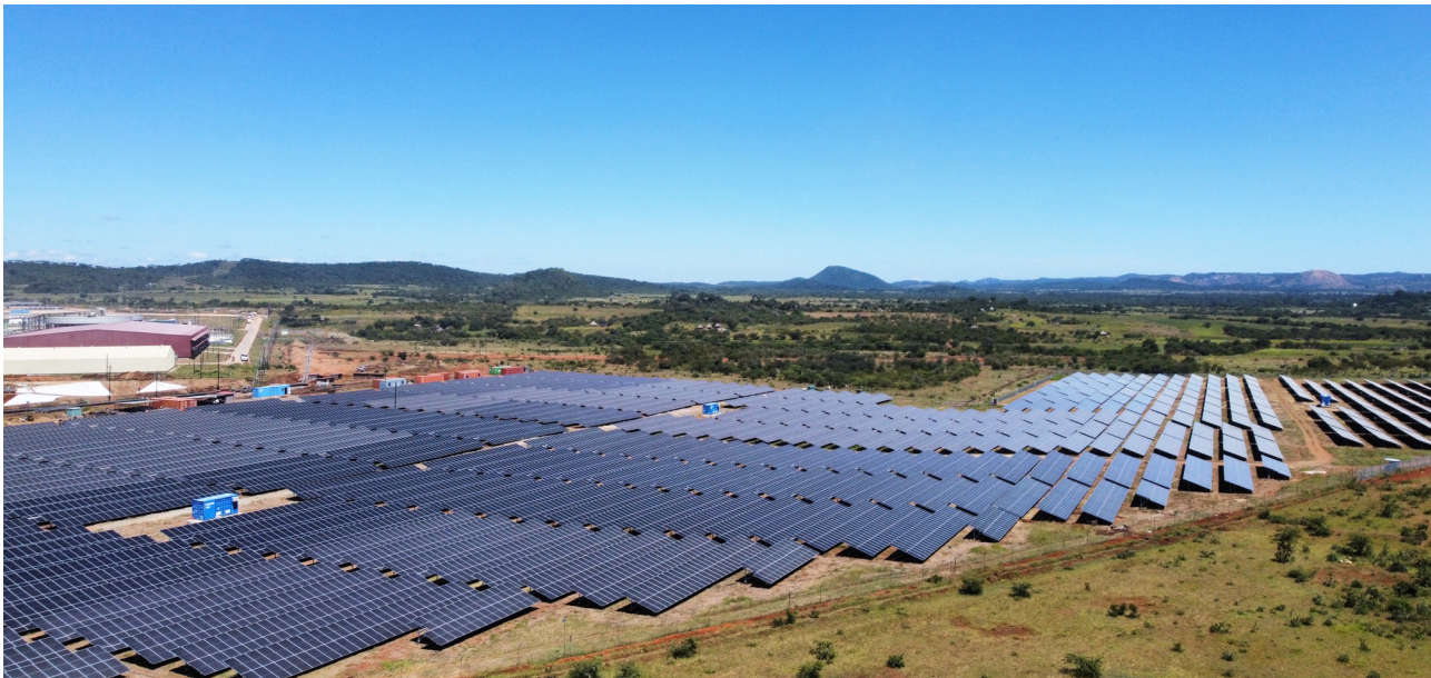
Bikita 矿山配套光伏发电项目工程建成并投入使用
