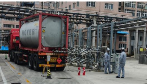
溶剂储罐及气相平衡系统
