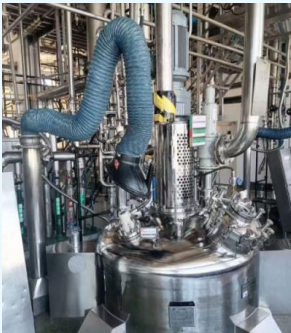
现场设置排风系统
