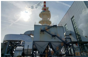
锅炉除尘净化设施
