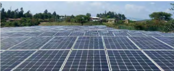
埃塞俄比亚南方州微型光伏电站
