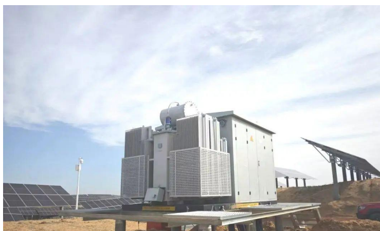
图：国内首台套 4.5MW 级大容量 35kV 非晶合金铝绕组箱变在华能陕西孟家湾二期光伏项目成功投运
