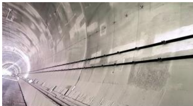
图：新型“13/8”扩频漏缆沈白高铁全国首试成功
