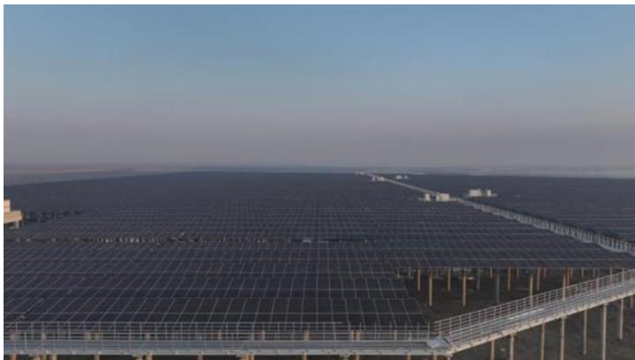
图：国华光氢储一体化 400MW 光伏项目
