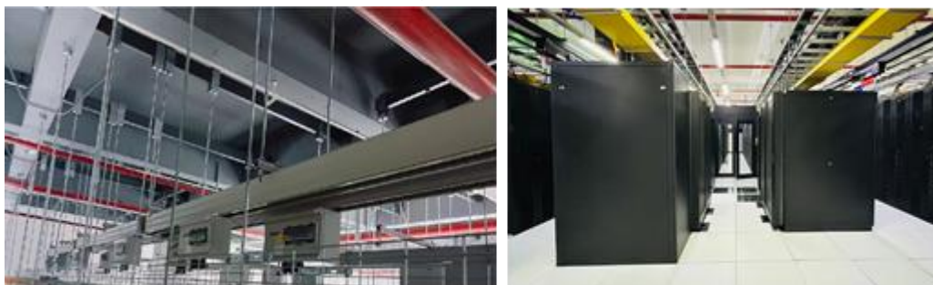
图：母线产品在中国电信山东分公司青岛云基地应用、数据中心新一代液冷技术在移动某数据中心应用
