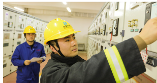
魏家峁煤电公司运行人员按照操作票顺序检查确认后对1#机组6kV设备开关送电
