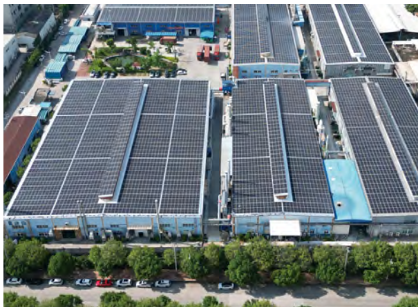
漳州建霖屋顶分布式光伏项目
