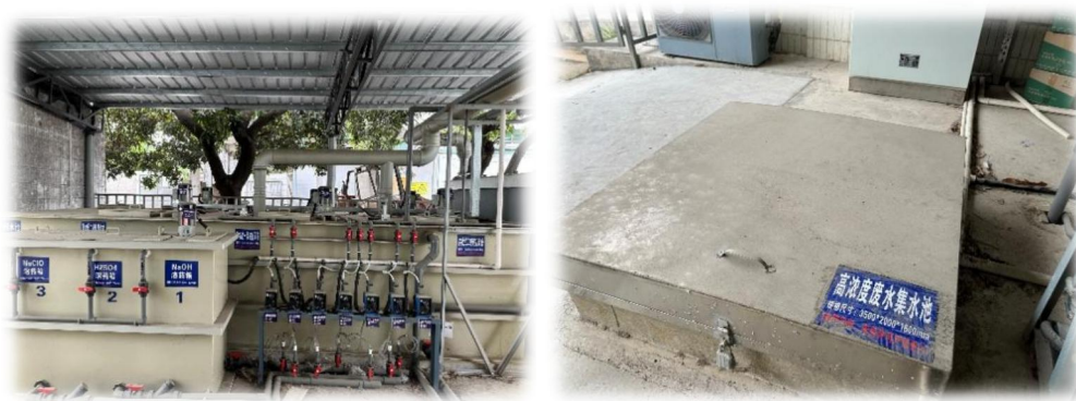
废水、废气处理工程
