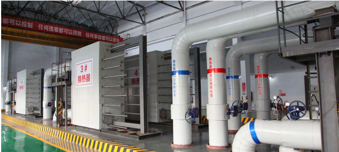
热力公司换热站
