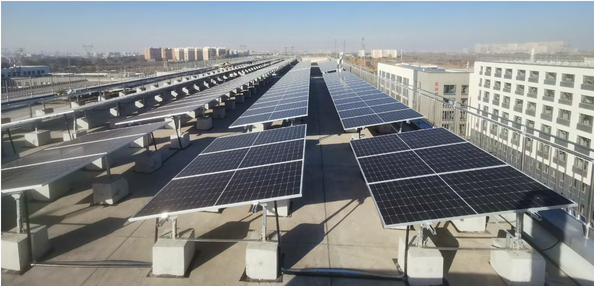
山西工程科技职业大学综合智慧能源项目
