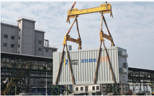
全球能耗最低的钢铁零碳工厂储能项目 中天钢铁10MW/20MWH储能项目
