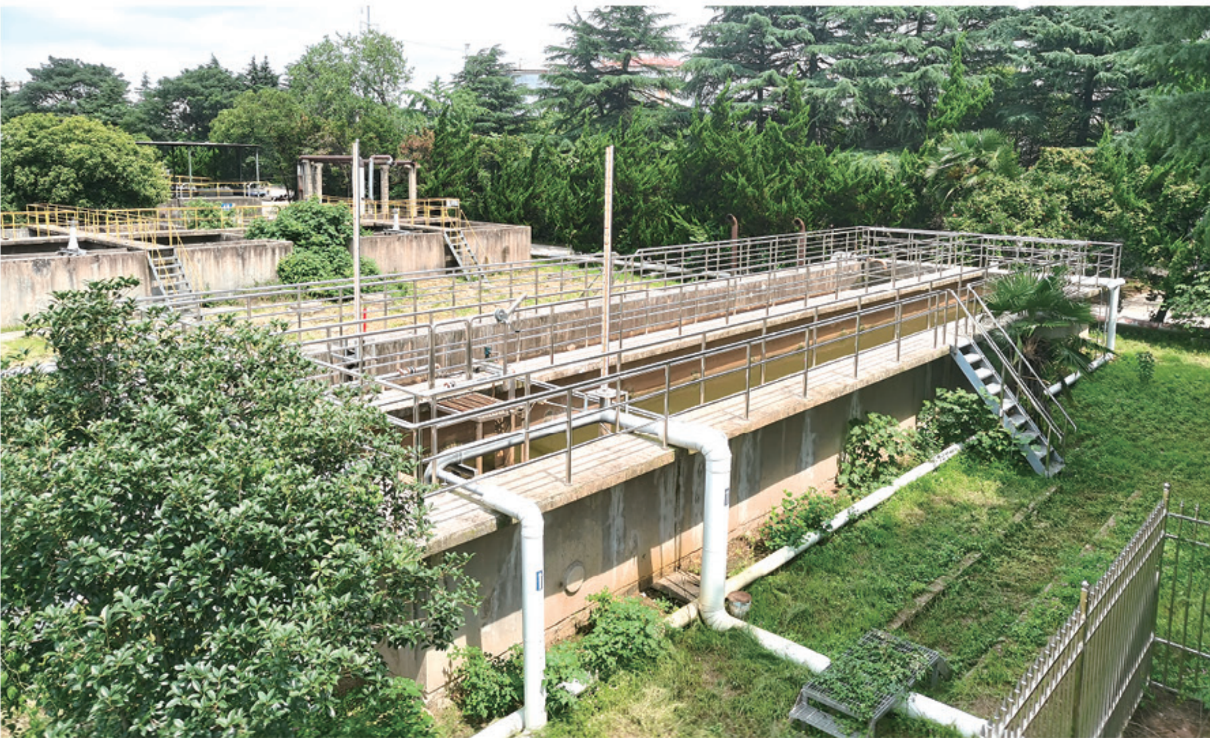
▲ 罐区污水处理站
