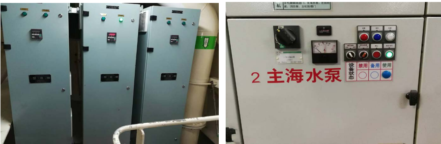
主海水泵变频控制系统
