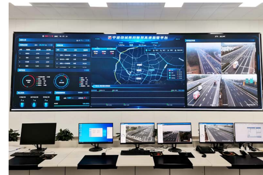
● 宁波绕城西段智慧高速监管平台
