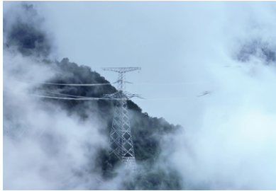
12月27日,中国电建参建的川渝1000千伏特高压交流工程建成投运,标志着我国西南电网主网架电压等级提升至1000千伏,实现了四川、重庆地区特高压交流联网构想。
