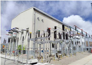
10月27日,在西藏日喀则市220千伏萨嘎变电站,中国电建设计的我国首套电网侧带超容构网型SVG(静止无功发生器)项目建成投运,相关技术性能达到世界先进水平。
