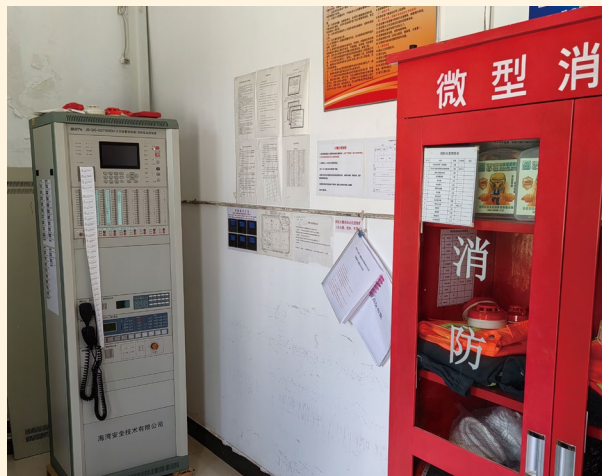
消防应急器材柜
