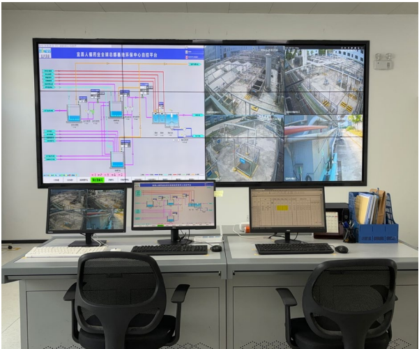
污水在线监控室
