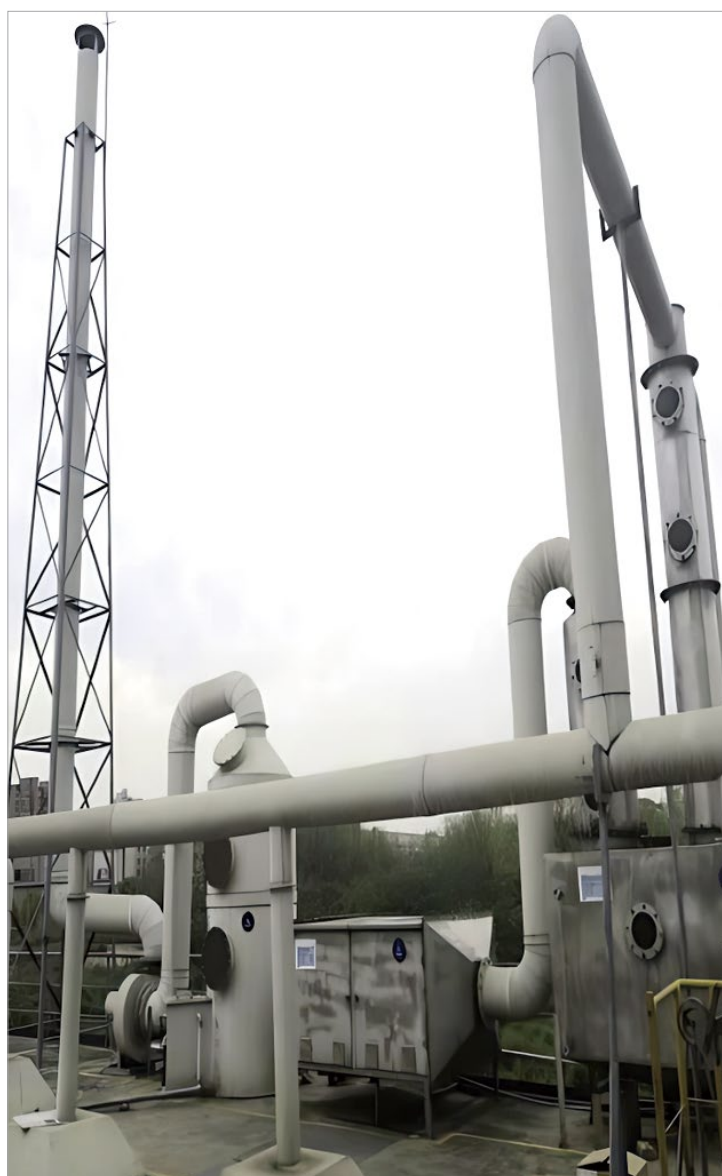
污水站除臭系统
