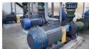
循环冷却水泵
