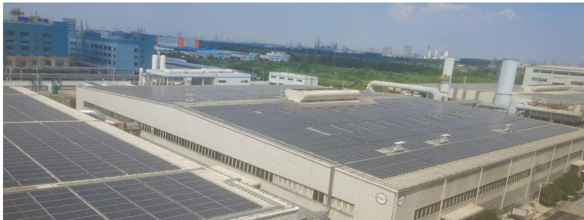
屋顶光伏发电板
