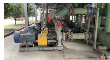
RTO 循环冷却水泵
