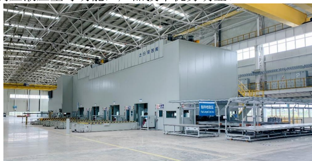
液压机自动化冲压生产线
