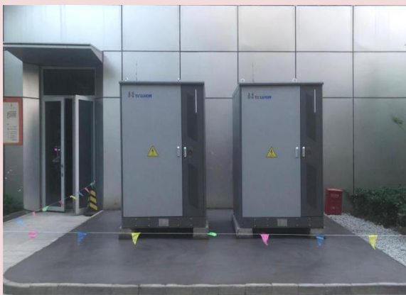
上海中泰广场储能项目
