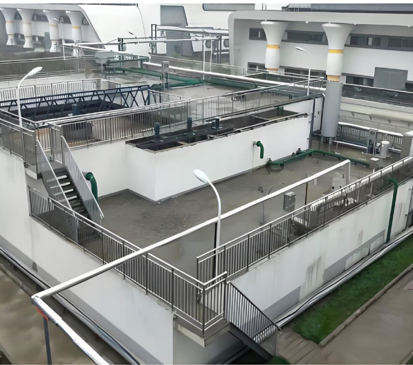
公司污水处理站
