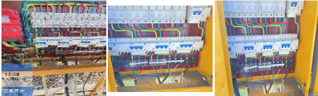
配电箱整改前 配电箱整改后 配电箱复查结果
