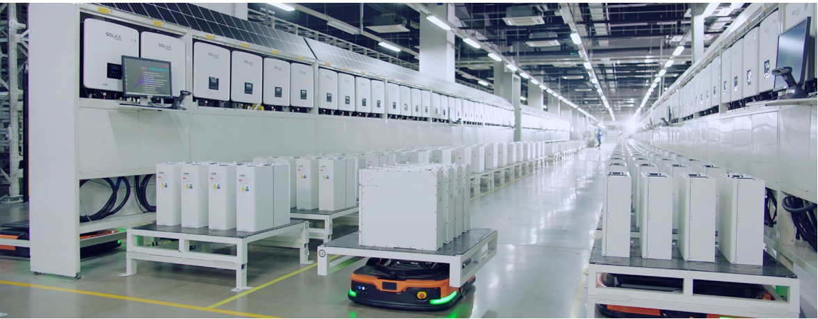
智能化电池检测系统
