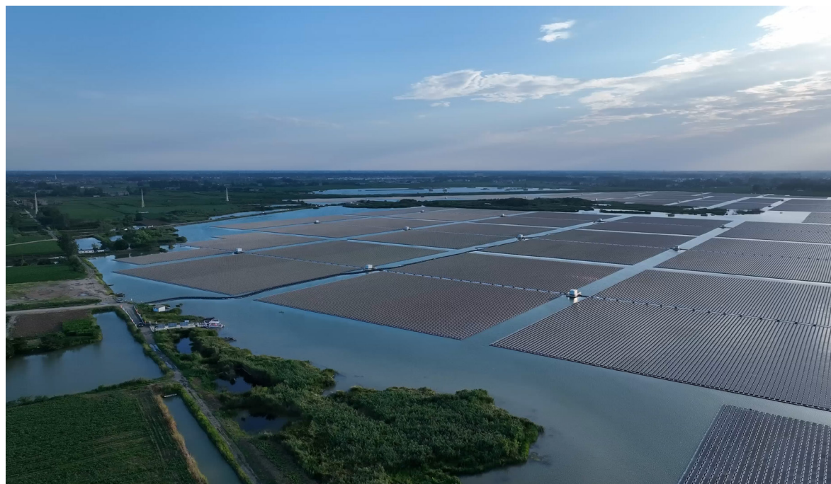
安徽阜阳水面光伏电站
