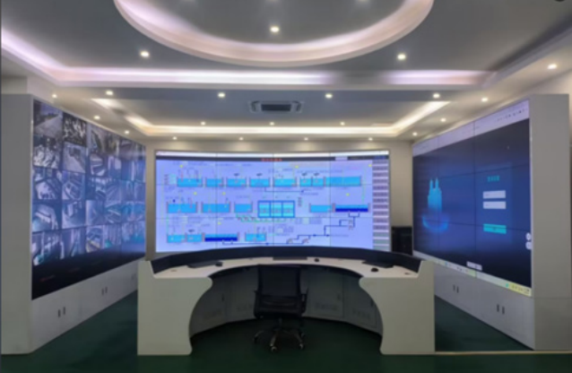
污水处理控制室
