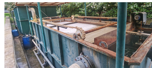
废水处理设施
