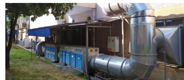
废气处理设施
