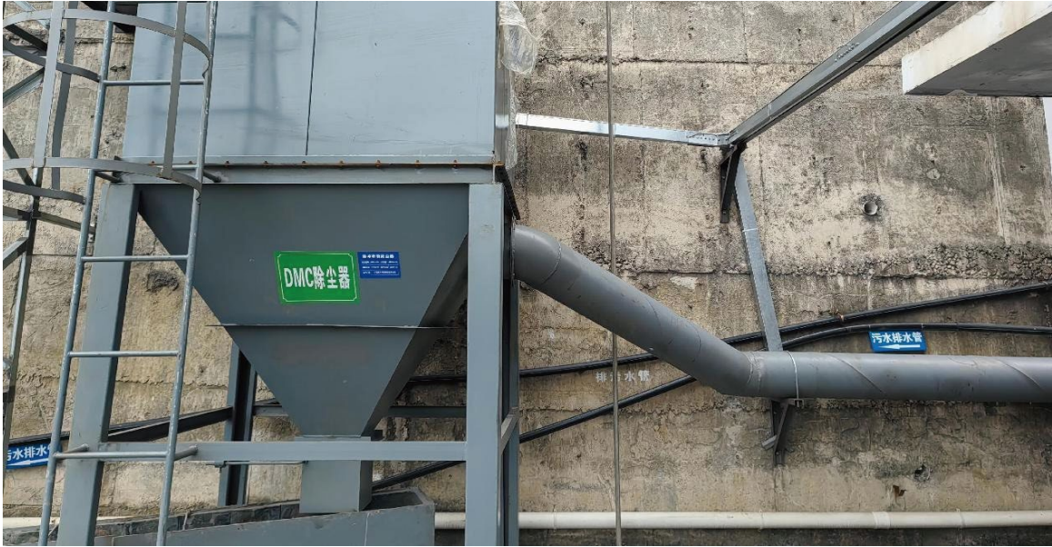
废气处理设施
