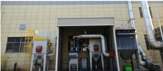
铝制件废气治理设施
