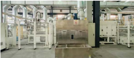
液冷板打磨线湿式除尘装置
