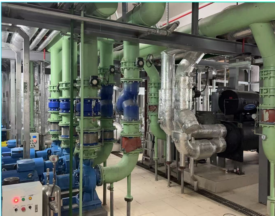
总部大厦采用更低能耗的水蓄冷中央空调制冷系统
