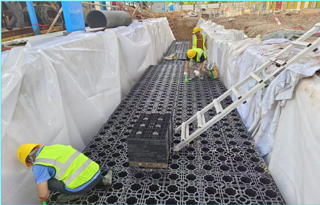
光峰科技总部大厦项目采用的 PP 模块蓄水池
