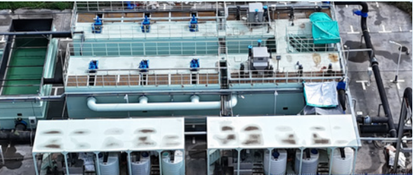
淮安光电三级深度除氟系统
