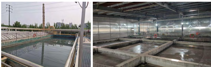
工业废水处理站
