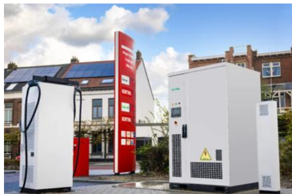
荷兰储充一体化项目
