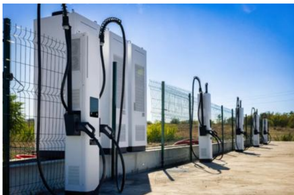
保加利亚兆瓦级充电 (MCS) 项目
