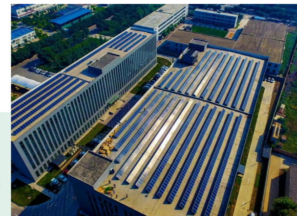
通合科技光伏发电矩阵
