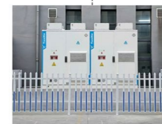
工商业储能产品应用于石家庄工业项目
