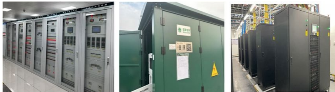
电力操作电源应用于变电站
