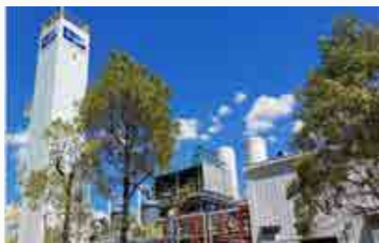
现场制氮节能技改
