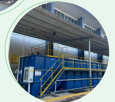
纬达光电一期废水治理设施
