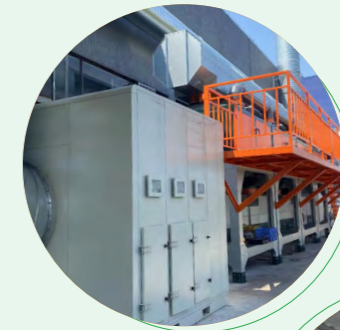
华韩公司 RTO 焚烧废气治理设施
