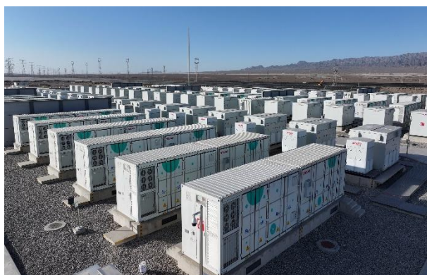
甘肃嘉峪关储能项目
