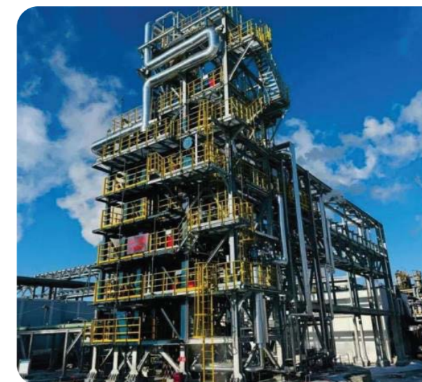
国内首套乙烯电裂解炉侧线装置
