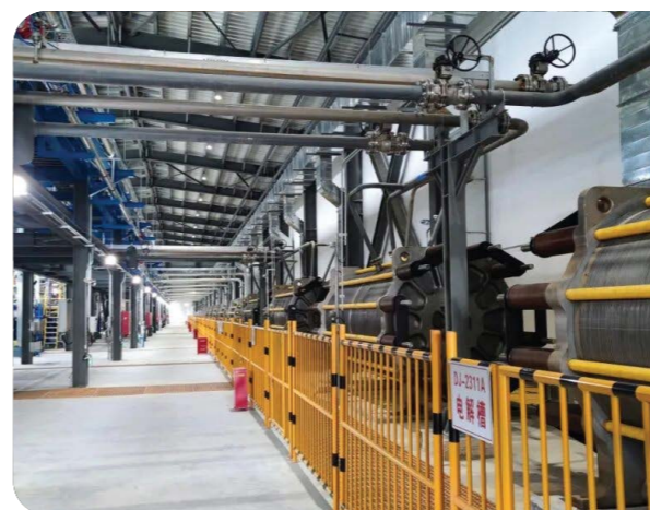
大安风光制绿氢合成氨一体化示范项目现场
