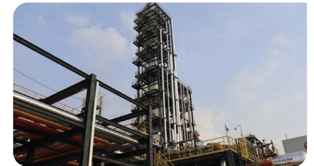
西南油气田盐亭天然气处理厂乙烷回收单元
