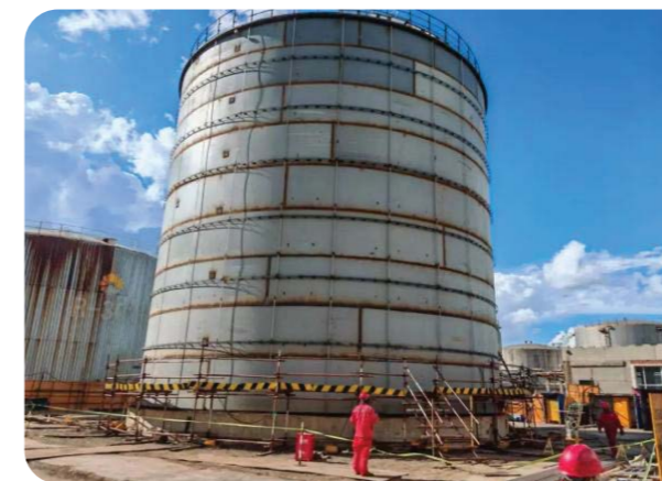
储罐VOCs治理项目
