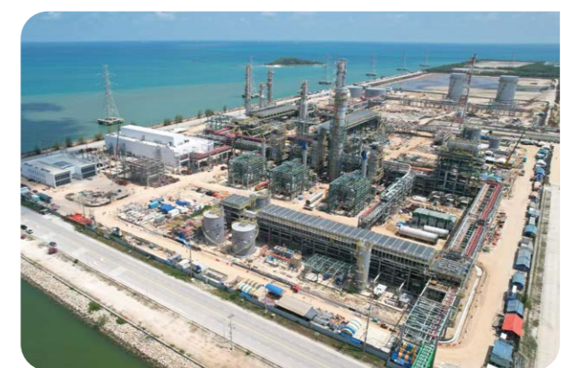
泰国天然气处理厂现场
