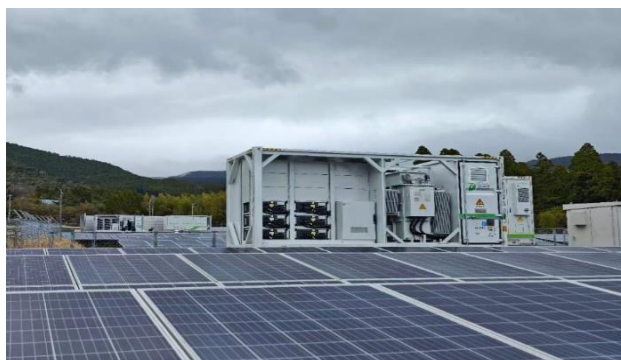
图 6：鹿儿岛 3.2MW/10MWh 储能项目
