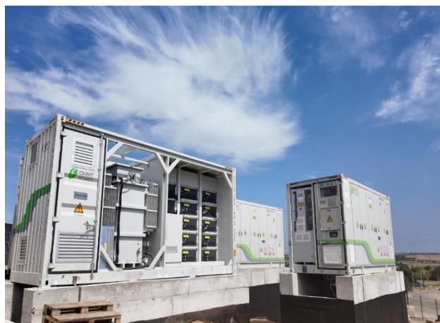
图 2：乌克兰 60MWh 储能电站一期项目
