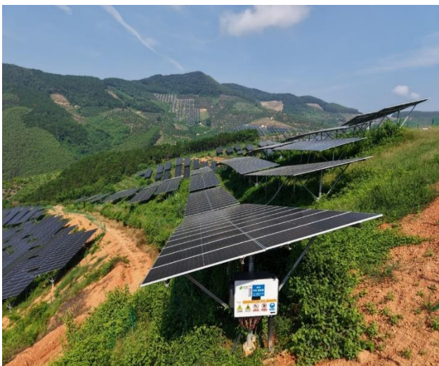
图 7：广西百色 300MW 光伏项目
