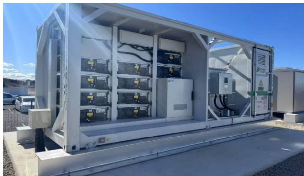
图 4：千叶 2MW/8MWh 储能项目
