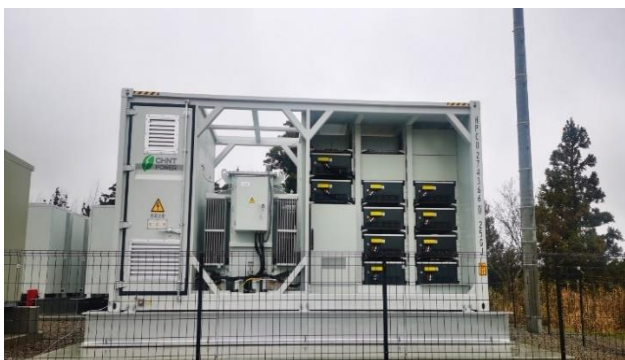
图 5：栃木县 2MW/8MWh 储能项目
