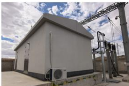
电气化装配式所
