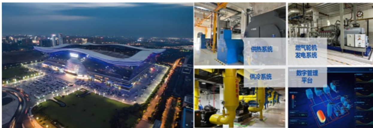
图 5：成都世纪新能源天然气冷热电三联供分布式能源项目
