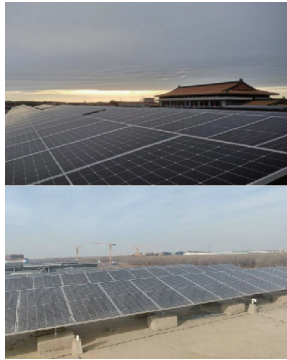
光伏发电设备
