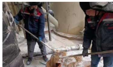
使用沙土覆盖泄漏液体
