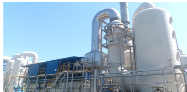
废气治理装置 RTO
